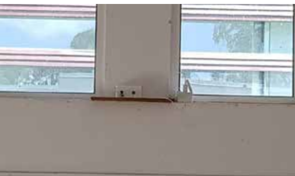
No Colégio, o módulo com os sensores está instalado no átrio do liceu.
